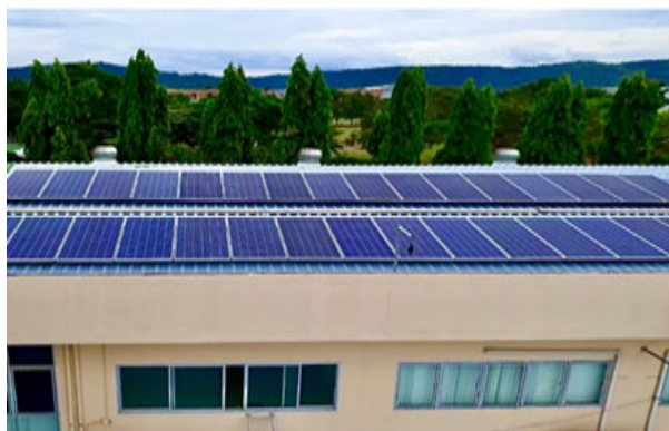
ภาพประกอบ Solar Rooftop บนหลังคาอาคารสำนักงานนิคม
